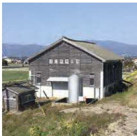
老朽化した江口排水機場
