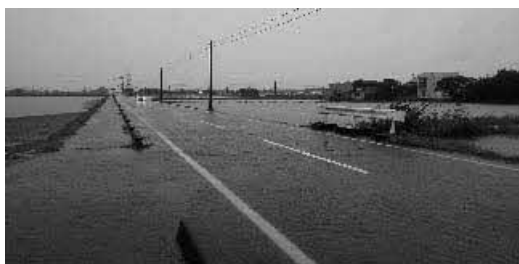
冠水した町道中津隈市原線(一軒屋交差点西)
