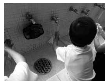
廊下に設置されている手動型の水道
