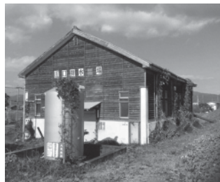
老朽化で閉鎖中の旧江口排水機場(東分区)
