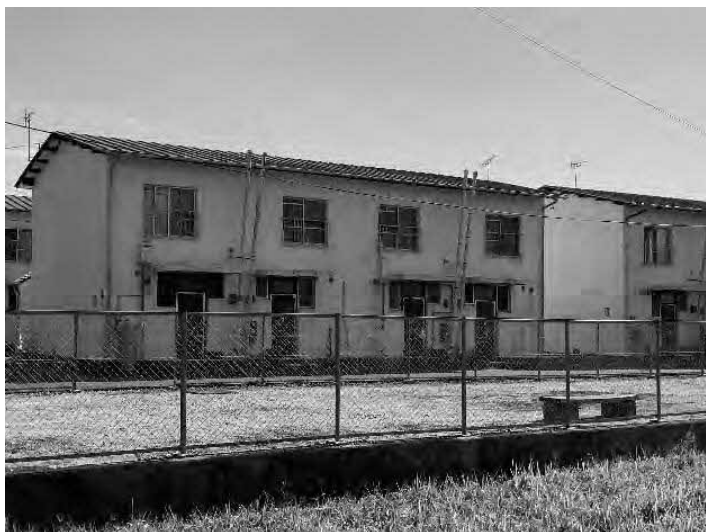
老朽化した天建寺団地
