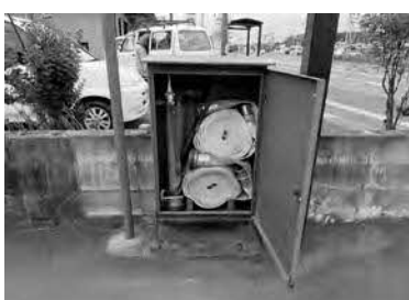
消火栓備品収納ボックス
