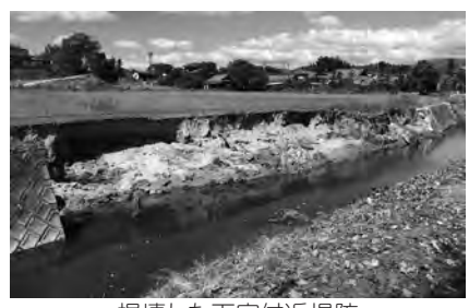
損壊した下宮付近堤防
