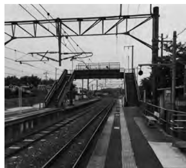
老朽化し危険性のある跨線橋
