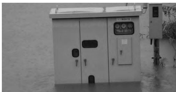
冠水のため使用できないサイホン調整
