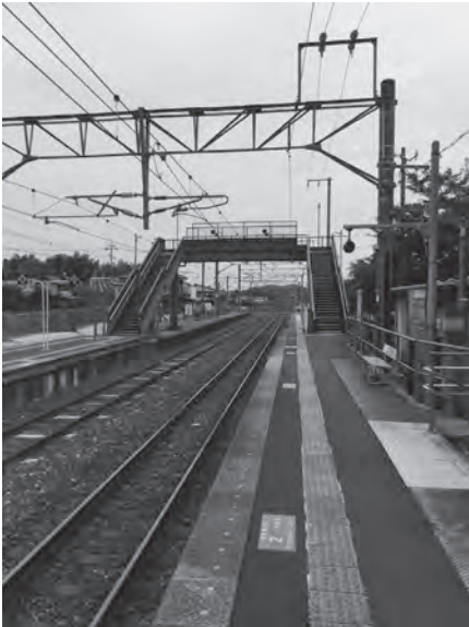
老朽化で通路が凸凹になっている跨線橋
