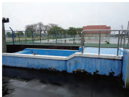
老朽化が進む三根東小学校プール
