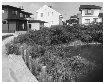
堤体の一部が薄くなっている栗崎ため池
